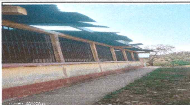
Foto 2: la parte de atrás el techo esta en total deterioro
